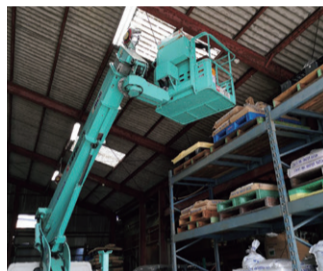
時にはリフトを使って罫を設置。天井裏に入り込んだりと過酷な作業もしています。
